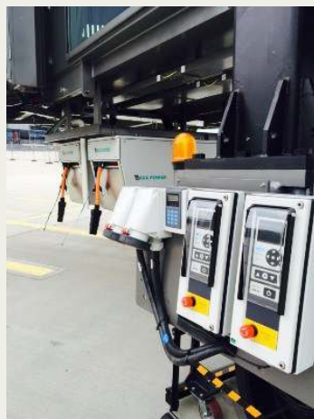
Installations fixes pour la fourniture d'électricité (400Hz)
